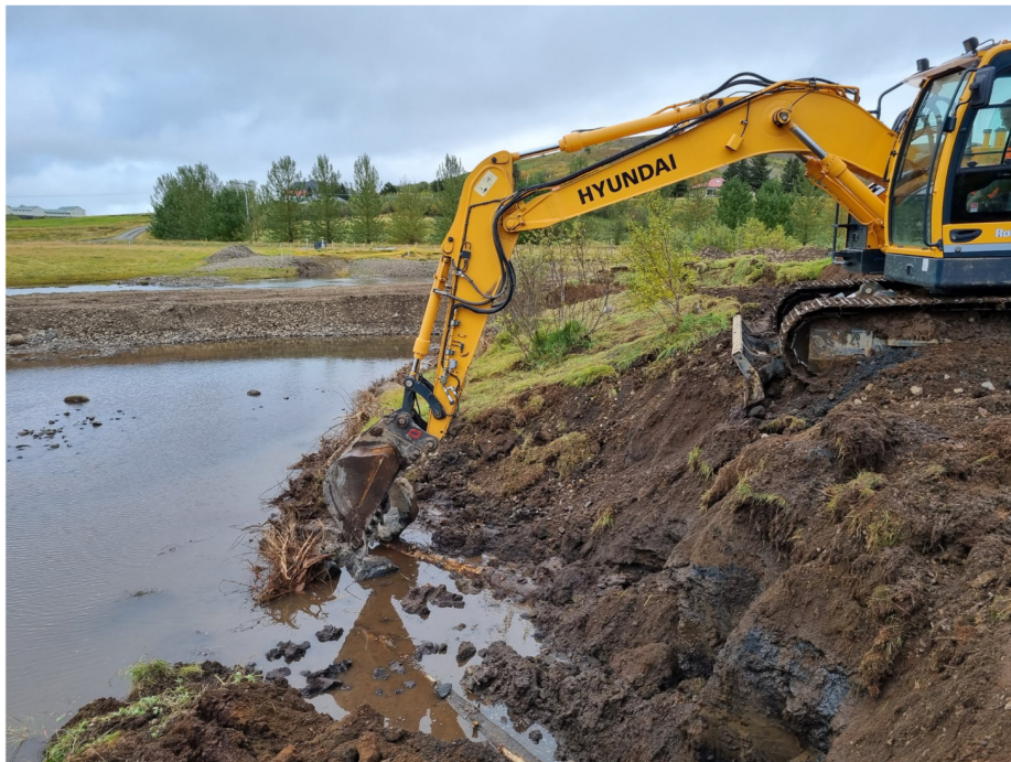
Bakkavarnir við Andakílsá 2021.
